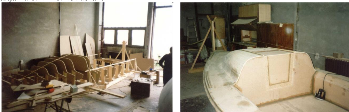
8.1.1. ábra: Az építőállványzat és rajta a bórdaváz (balra), a belécezett és pozdorjalemezzel borított szerkezet (jobbra)
